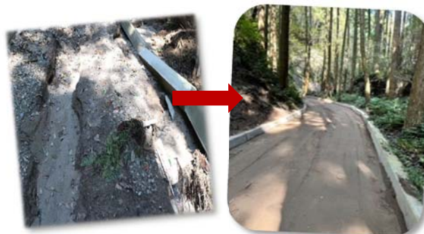
沈砂池に続く道に亀裂が生じ、通行ができなくなったため、現在補修中。
